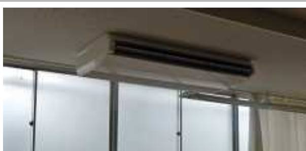
各教室にエアコンの室内機が設置されました。
